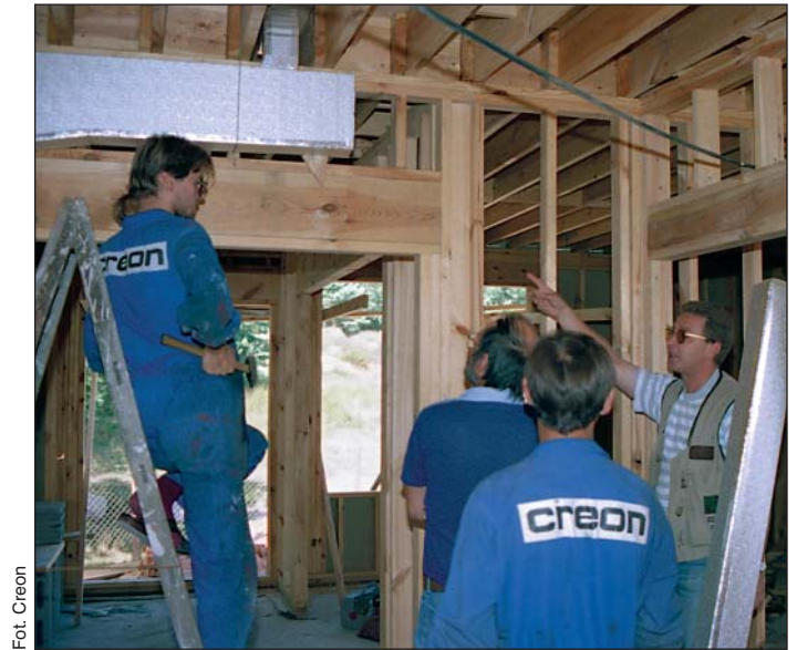
Fot. 4 Montaż kanałów ogrzewania powietrznego w domku o konstrukcji szkieletowej. Kanały te są sklepane bezpośrednio na budowie z płyt poliuretanowych lub wykonanych z maty szklanej
