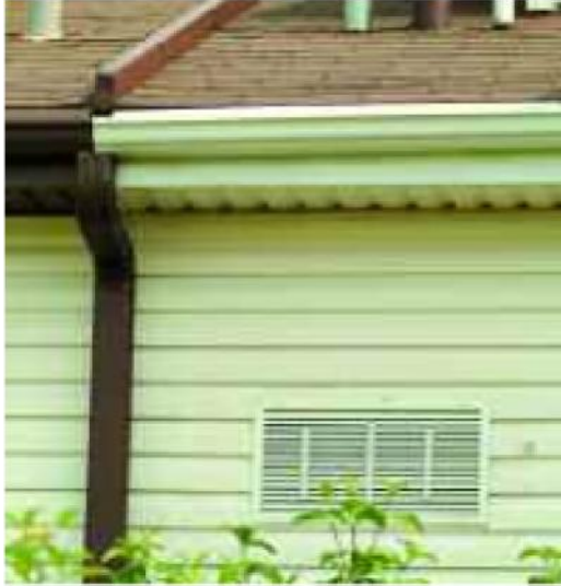
Czerpnia zewn trzna. Dostarcza wie e powietrze do wentylowania budvniku
