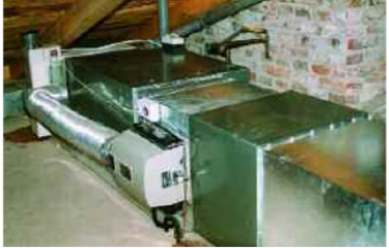
Piec z elementami instalacji nadmuchiowej umieszczonej na poddaszu
